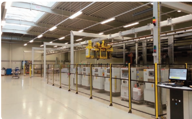
Bild 3: In einer vollautomatischen Krananlage bei der Firma 4packaging realisiert ein Hima-Sicherheitssystem die Sicherheitsfunktionen.
